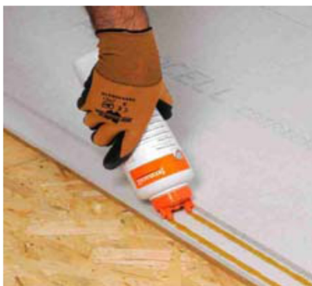
Aanbrengen van de fermacell Vloerelementen montagelijm in twee strengen op de liplas
