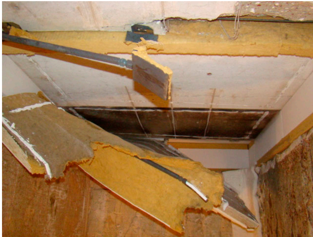
Foto C.4: Unterseite der Hohlplatte nach Entfernung der 100 mm Facett Platte
