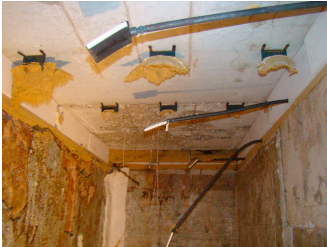
Foto C.2: Ansicht nach Erhitzung und Abkühlung
