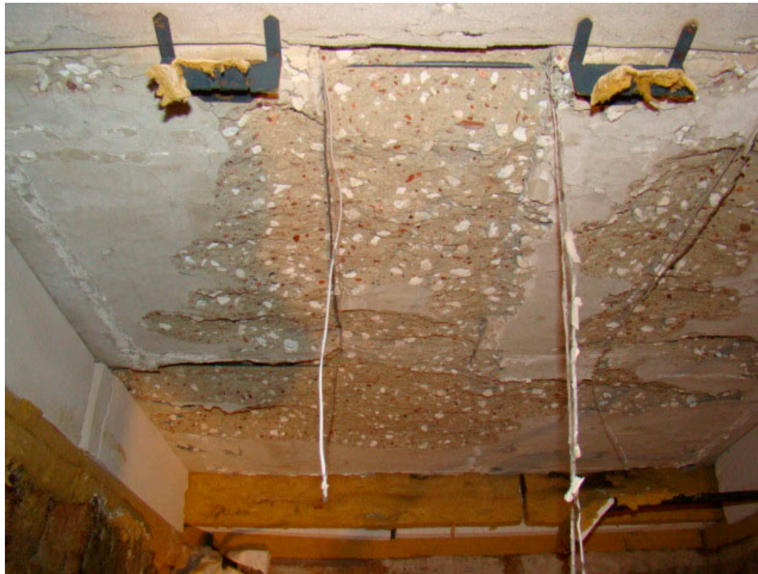
Foto C.3: Unterseite der Hohlplatten nach Erhitzung und Abkühlung
